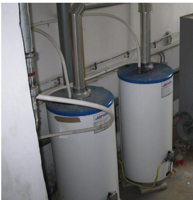
Obr. 5: Zásobníkové plynové ohrievače vody v bytovom dome
