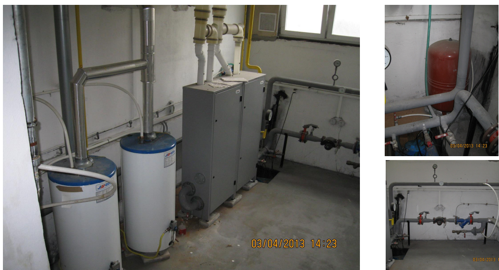
Obr. 4: Kotelňa v bytovom dome
